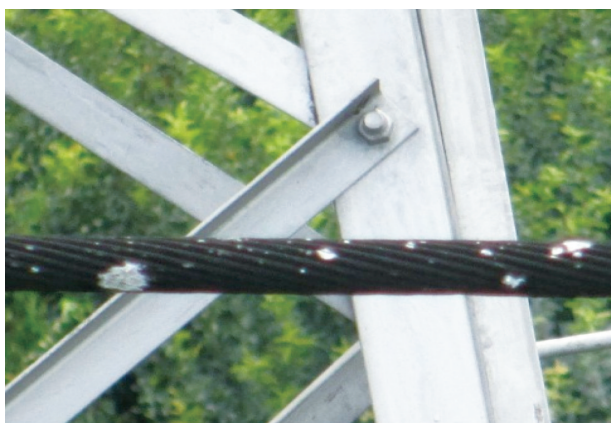
图1 东三线风偏故障导线放电痕迹
