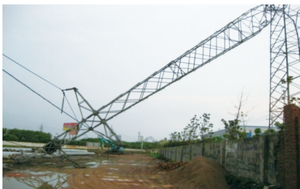
图2 西亭线倒塔现场
